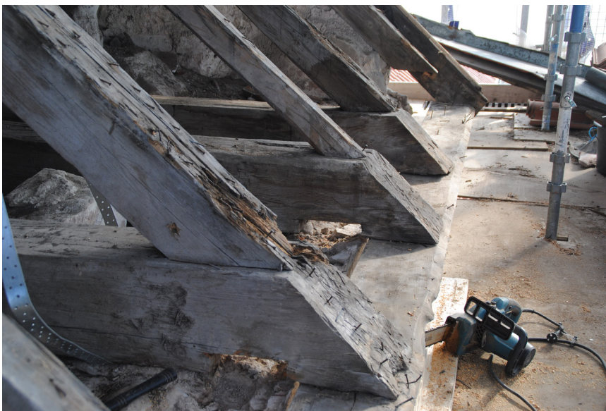
I takfoten på södra sidan var hela yttre remstycket rötskadat. Det fanns även rötskador på de yttre bjälkarna och på takstolarna.
