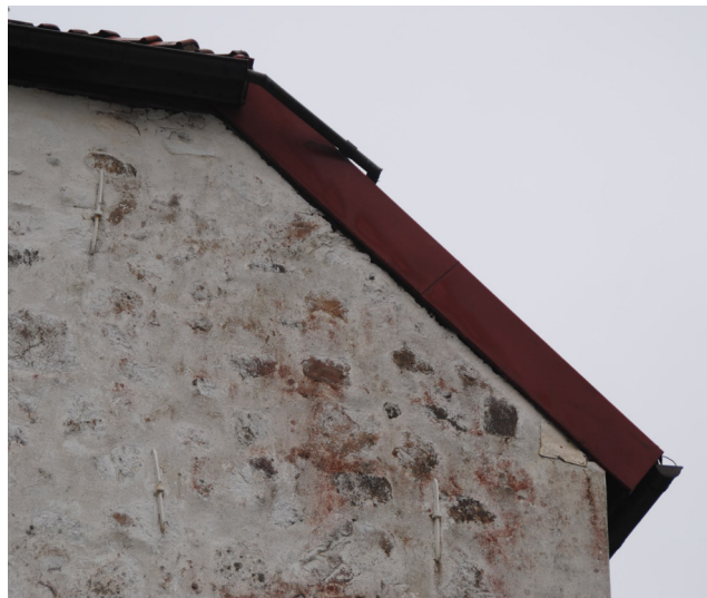
Fasaden har ingen täckande puts utan är kalkad på både putsfog och natursten. På en del ytor var färgskiktet helt borta på naturstenen.
