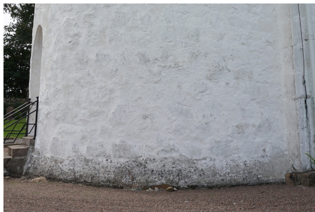
Närmast marken hade fasaden skador runt hela kyrkan. Här fanns även lite putsbortfall.
