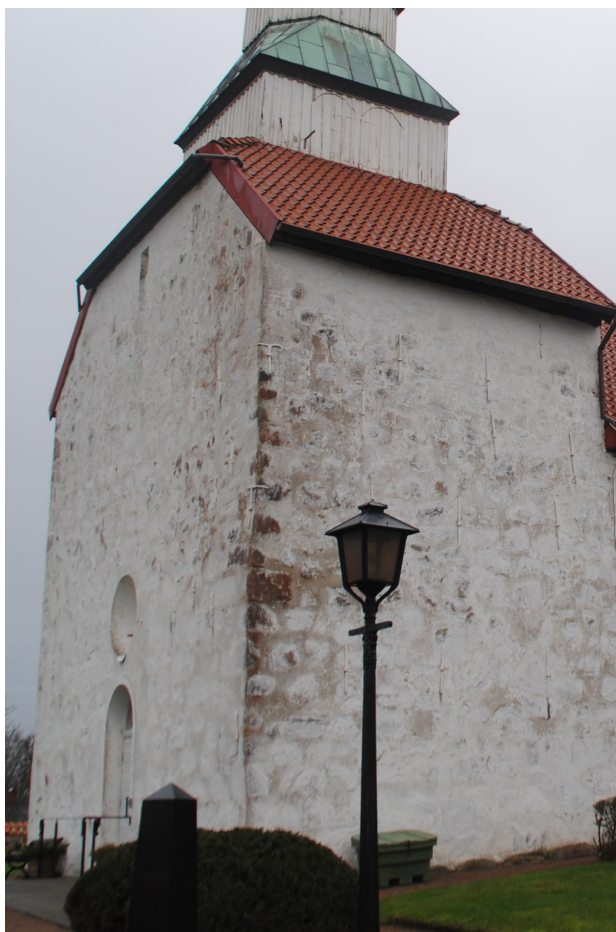
Tornets västra och södra sida hade mest skador, med algpåväxt, missfärgningar och vittrat färgskikt.
