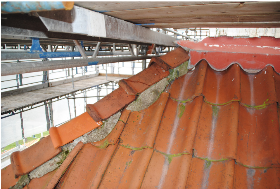
Sidonockarna på tegeltaket var satta i bruk. Det fanns nockpannor som var spruckna och som var lösa.
