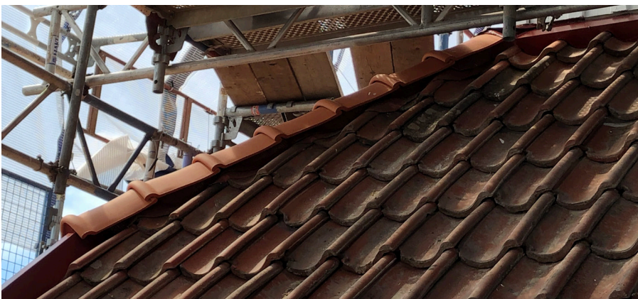
Sidonockarna var tidigare murade men har nu skruvats fast med nockband som tätning under.
