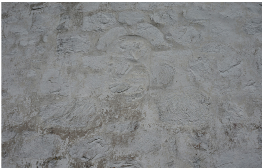
Genom att fasaden inte har en täckande puts syns historiska spår tydligt på fasaden. Här syns den fina valvbågen till ett medeltida fönster på långhusets södra sida. Fasadens färgskikt är vittrat och missfärgat.
