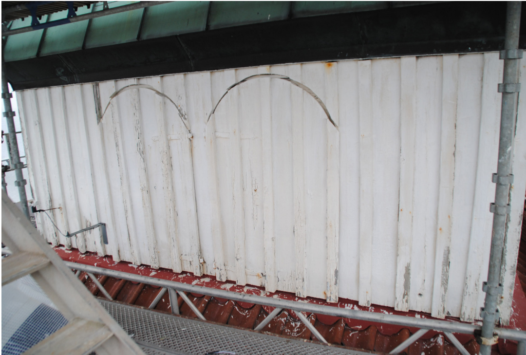
Tornväggarna av trä hade en del rötskador och var i behov av ommålning.
